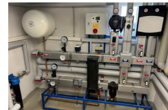
Derendingen, Sudetenstraße, 3, Fernwärmeübergabestation
