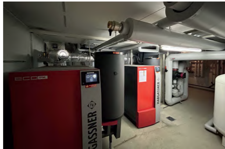
Mössingen, Butzenbad- / Weidenstraße, Heizraum mit Heizkesseln
