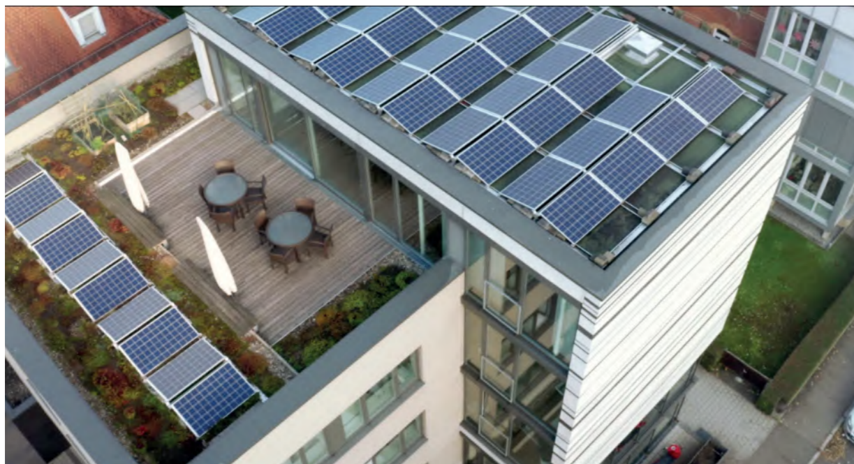
Photovoltaikanlagen auf dem Dach der Geschäftsstelle der Kreisbaugesellschaft Tübingen, Hechinger Straße 22
